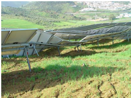
Durch Mure beschädigter Bereich
